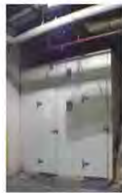
圖 7-3 垃圾冷藏設備
